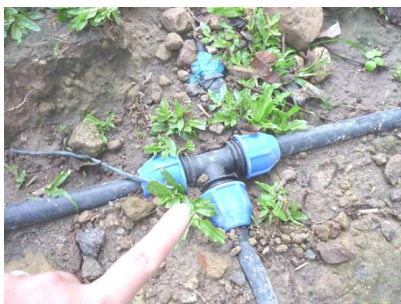
公共水場をつなぐパイプとコネクター この管理も水道組合の仕事
